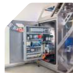
Quadro elettrico a scomparsa
